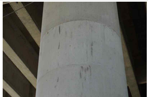
교각 망상균열 P3
