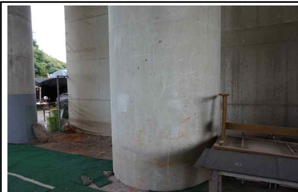
교각 망상균열 P1
