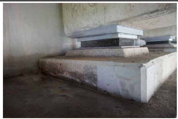
받침 콘크리트 박리/철근부식 A1 SH5
