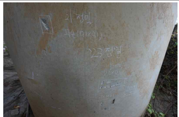
교각 파손 P3
