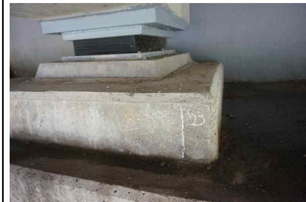
받침콘크리트 균열(0.3mm미만) A1 SH3
