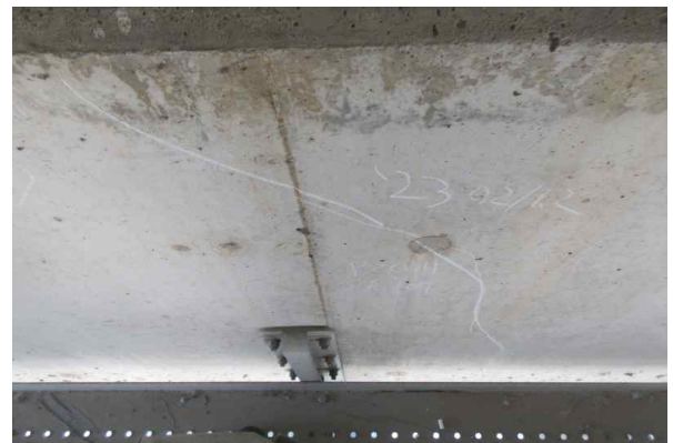
교각 균열(0.3mm 미만) P2
