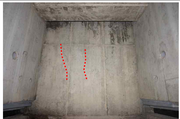
교대 균열(0.3mm미만) A2
