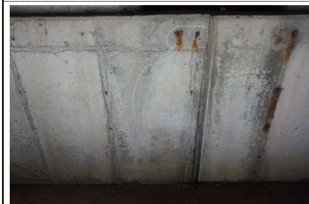
교대 균열(0.3mm미만) A2
