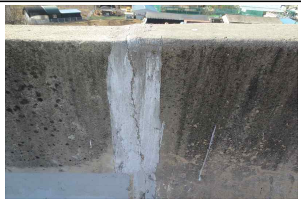
방호벽 보수부 재균열(0.3mm 이상) S3
