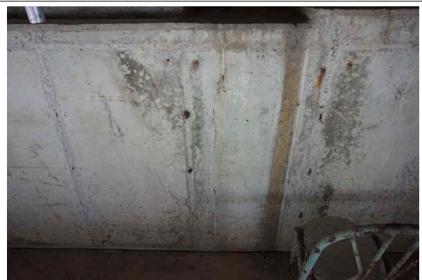
교대 균열(0.3mm미만) A2
