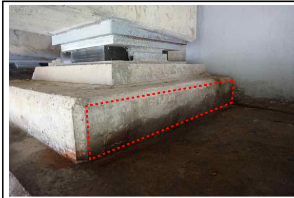
받침콘크리트 박리/철근부식 A1 SH6
