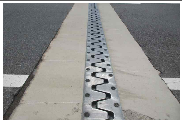
후타재 균열 Exp.Joint-P2
