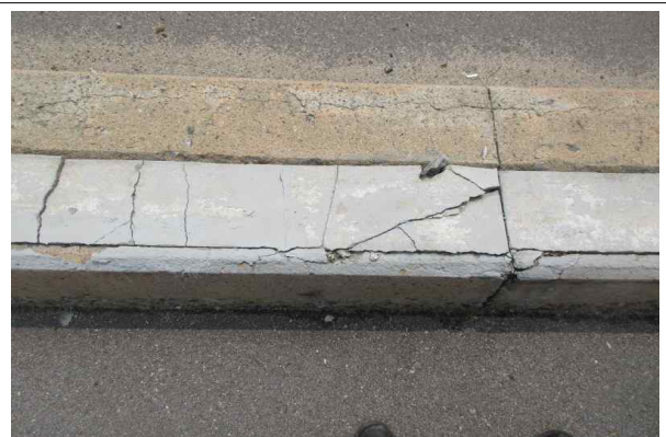
중앙분리대 보수부 박락 S4
