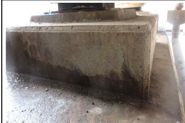
받침콘크리트 박리/철근부식 P2 A2-SH6
