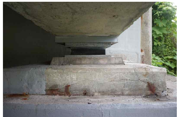
받침콘크리트 박리/철근부식 A1 SH1
