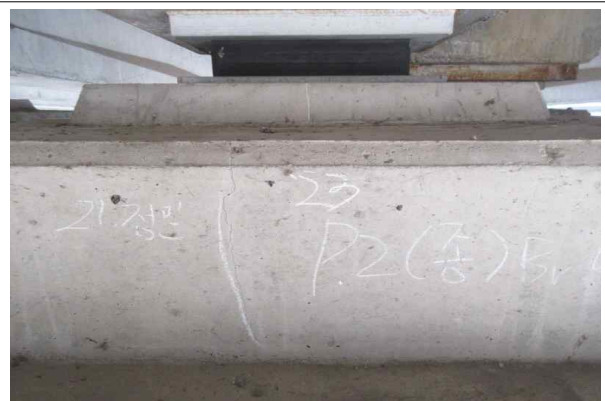
받침콘크리트 균열(0.3mm미만) P2 SH5
