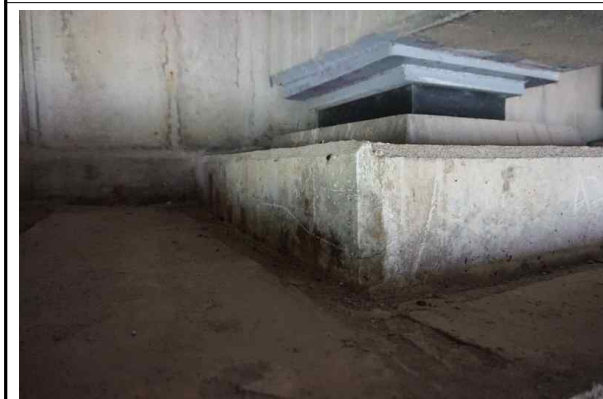
받침콘크리트 박리 A2 SH3
