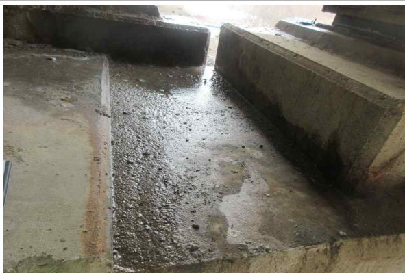
교각 누수흔적 P2
