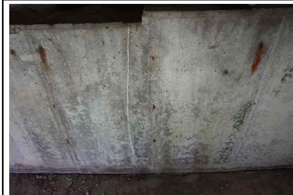
교대 균열(0.3mm이상) A2
