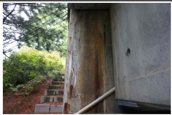
교대 망상균열 및 백태 A2
