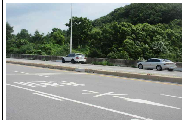
중앙분리대 차선 규제봉 탈락 S2~3
