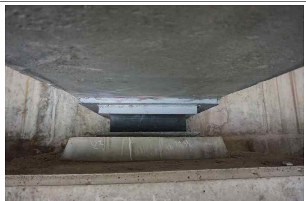
받침몰탈 균열(0.3mm미만) A2 SH6
